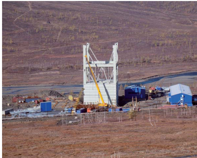
Der Schachtplatz im September 2009; von links nach rechts: Trägerstruktur für die 110 kV-Station, Teil des endgültigen Förderturms mit 45 m von 66 m endgültiger Höhe, 6 kV-Station, vorläufige Lüfterhalle, vorläufiges Sozialgebäude
