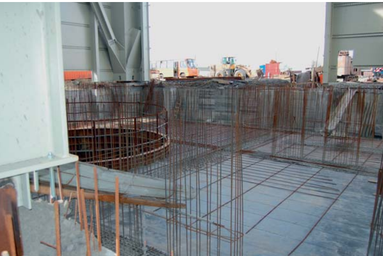
Vorbereitung von Betonierarbeiten für den Schachtkeller mit etwa 2.800 m 3 Beton parallel zur Errichtung des endgültigen Fördergerüsts
