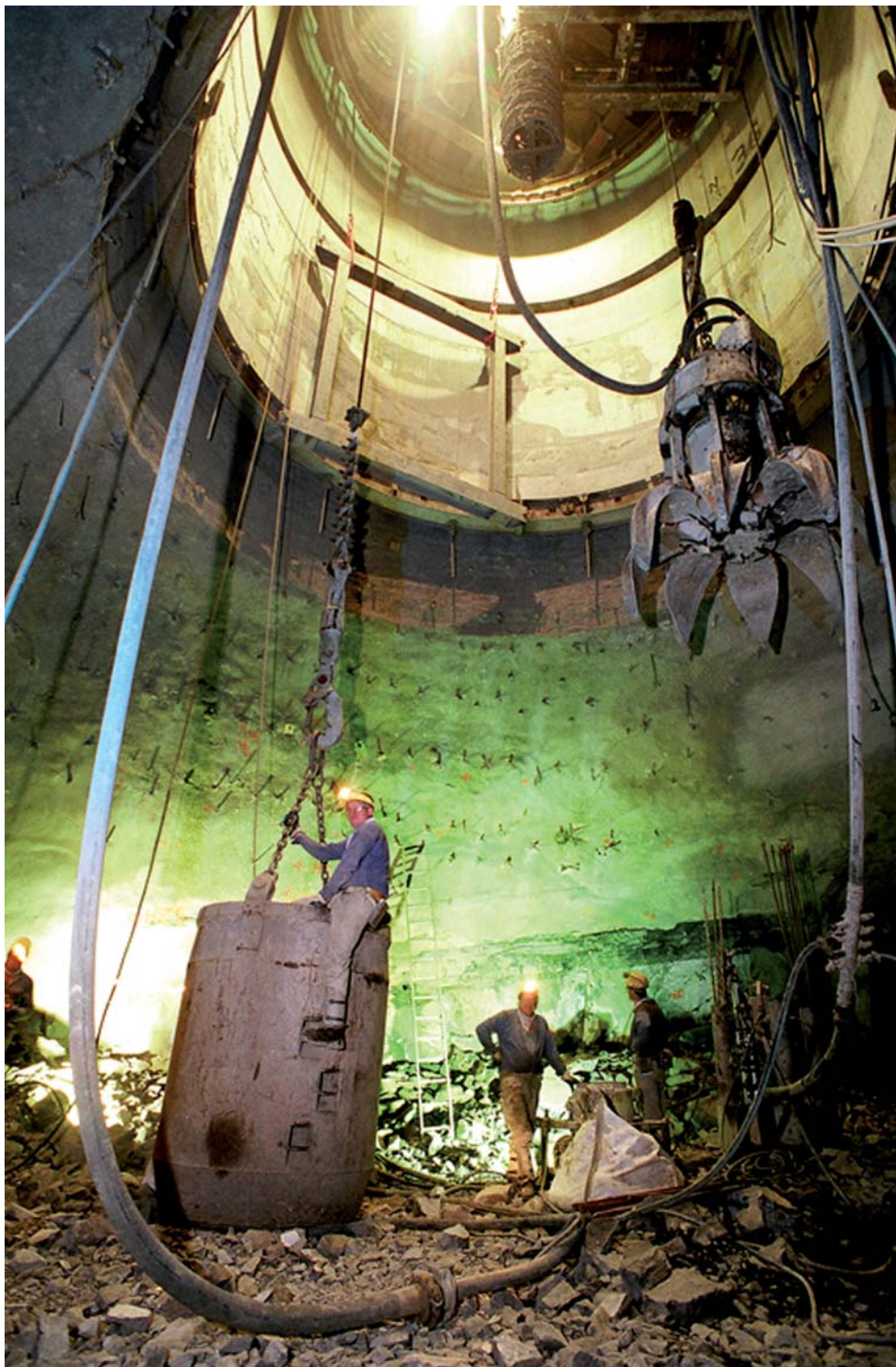
Vertikalübersicht im Bereich der 7. Sohle mit vorläufigem Ausbau und Blick in den Schacht
