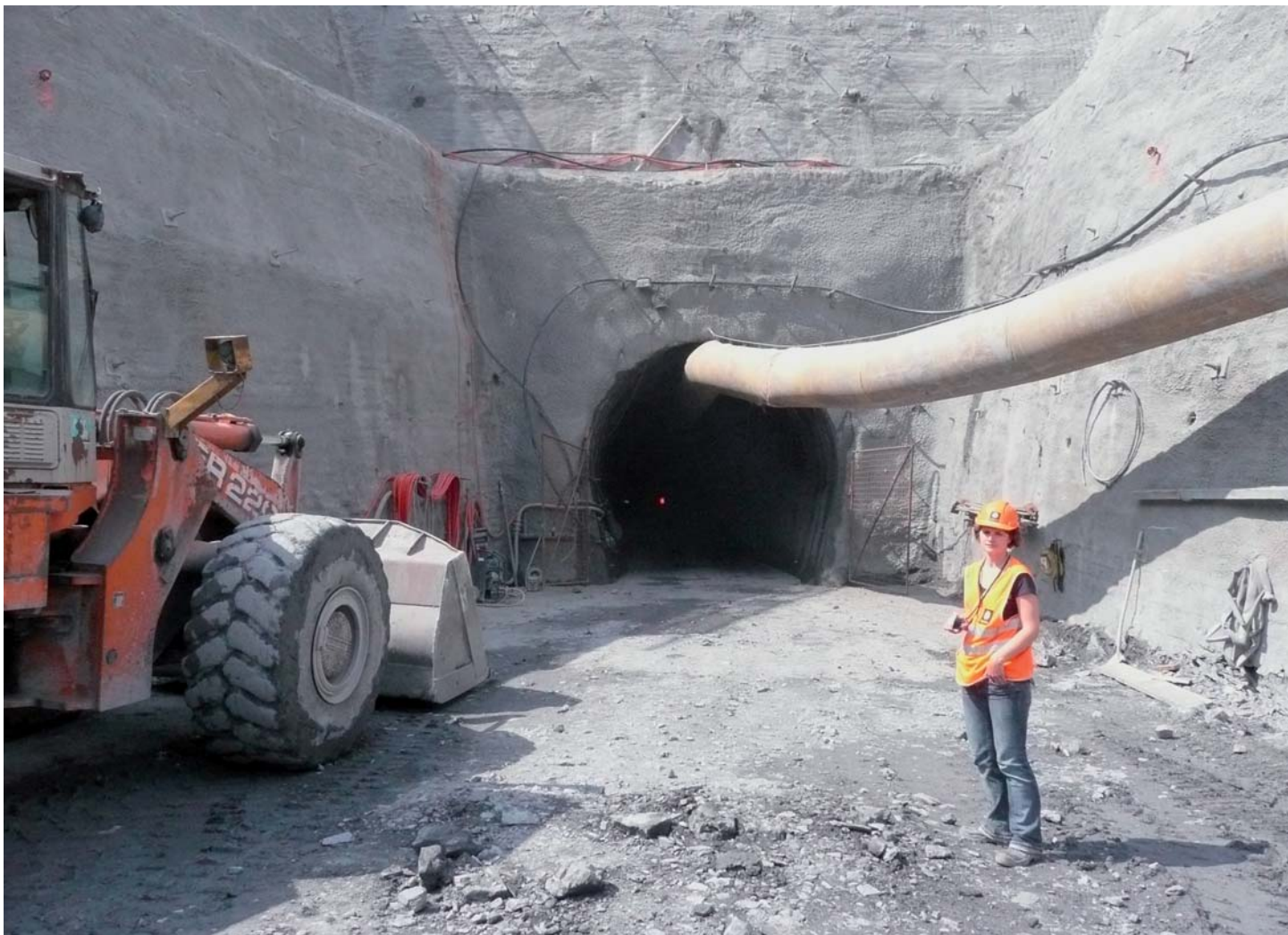
Unten: Stolleneingang zur Installationskammer
